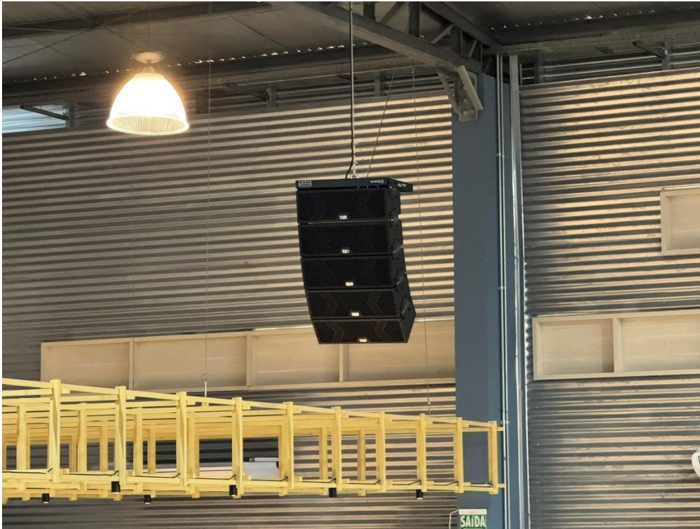
Figura 9 - Torre Line Array Suspensa
